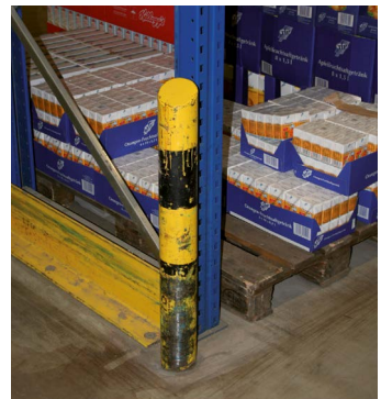
Abb. 14 Besonders stabil ausgeführter Anfahrschutz
